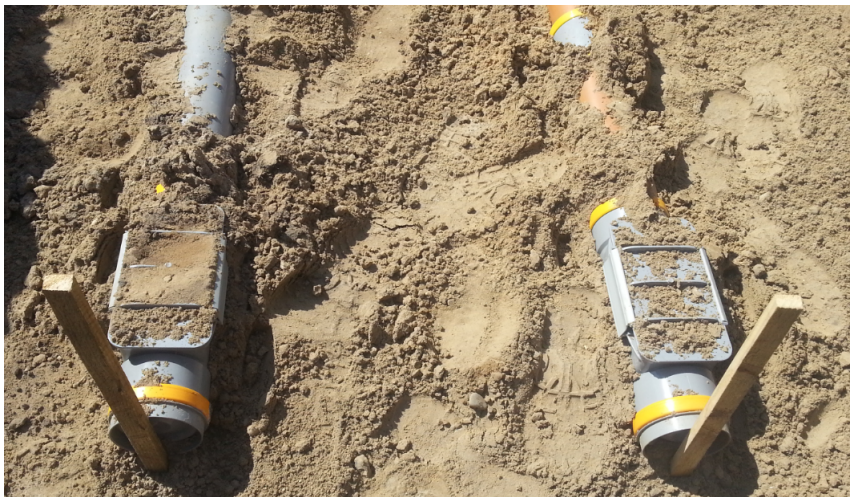
Figuur 14: gescheiden inzameling in Valleipark, op de erfgrans twee ontstoppingspunten
