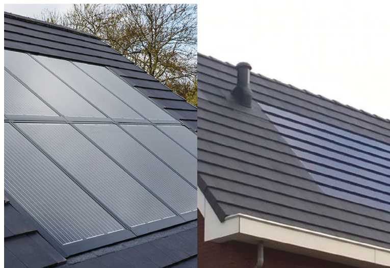
Figuur 10: In het dak geïntegreerde zonnepanelen.
