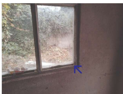
foto: afdichting - schuur
