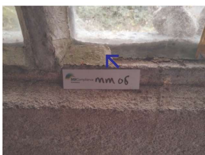
foto: afdichting - schuur
