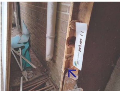
foto: afdichting - schuur
