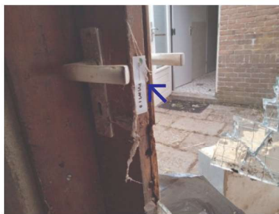
foto: afdichting - schuur
