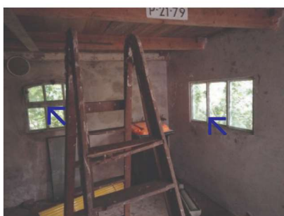
foto: afdichting - schuur
