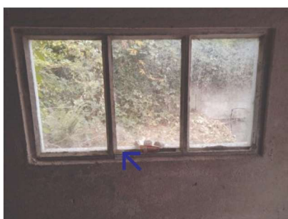
foto: afdichting - schuur
