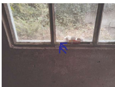
foto: afdichting - schuur
