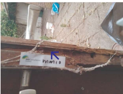
foto: afdichting - schuur
