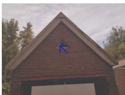
foto: afdichting - schuur
