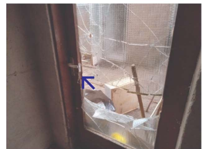
foto: afdichting - schuur
