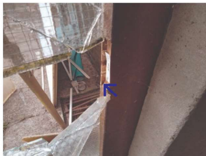
foto: afdichting - schuur
