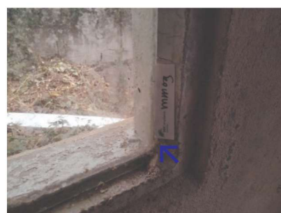
foto: afdichting - schuur
