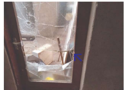
foto: afdichting - schuur
