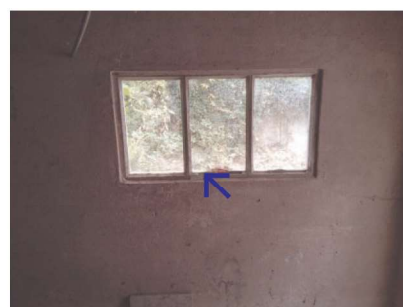
foto: afdichting - schuur
