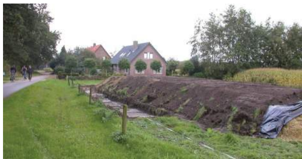
kuilplaats onopvallend met aarde afgedekt en beplant
